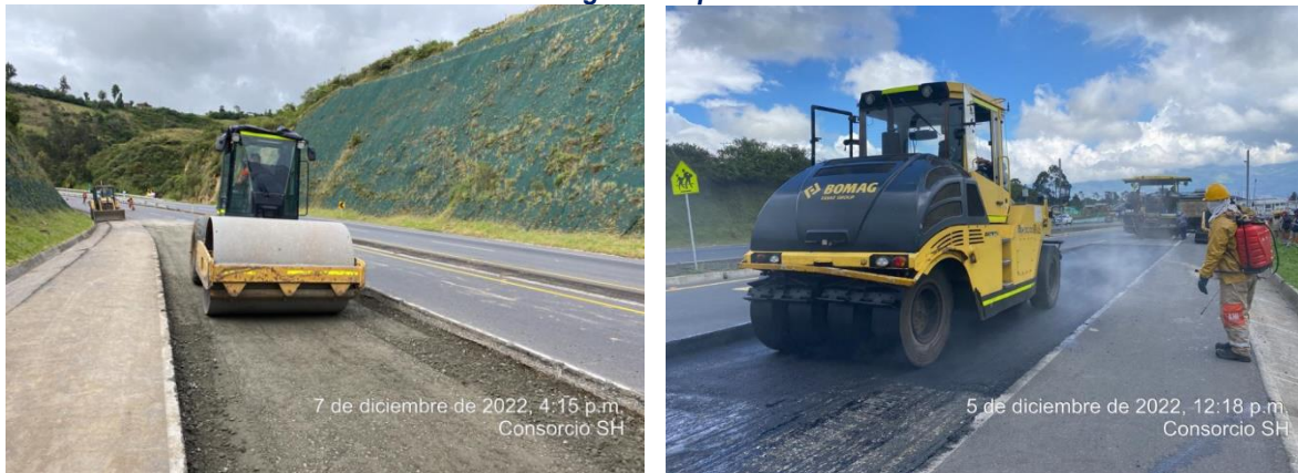
Ilustración 7. Registro Reparaciones UF 5.1
